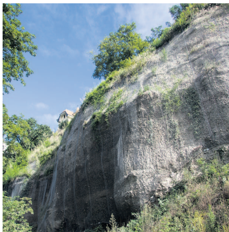
Les falaises débarrassées de leurs arbres sont enveloppées. 5000 m 2 de treillis ont été posés. La fixation des filets a exigé le percement de 350 forages d'ancrage en béton de 5 mètres de profondeur en moyenne. Il a fallu procéder par tests et essais erreurs pour déterminer la profondeur adéquate des forages en fonction de la couche traversée : moraine, sable, gravier, poudingue...
