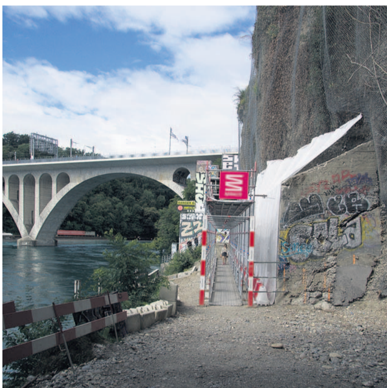
Depuis 2015, les expertises ont montré que la galerie de protection était en si mauvais état que la sécurité n'était plus assurée. Elle est démolie en 2024 et sera remplacée par une passerelle au-dessus du Rhône qui éloignera les promeneurs de la zone des chutes de pierres.
