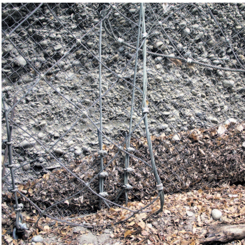
Les filets employés sont du type « filets pendus ». Fixés en haut et lestés en bas, ils laissent un vide entre eux et la falaise. Ils guident les pierres qui chutent et les éboulis s'accumulent en bas des filets, nécessitant un travail de nettoyage environ tous les deux ans.
