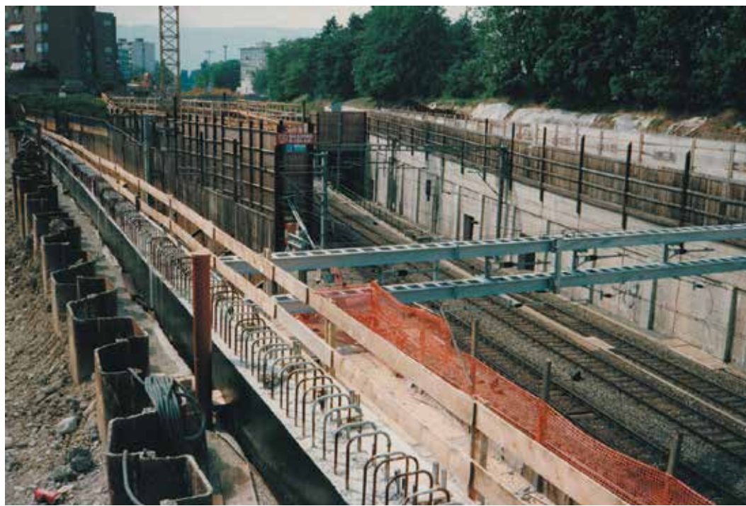
Édification des murs et pose des premières poutres vers le pont Miléant. Photos Jean-Paul Laurent.
